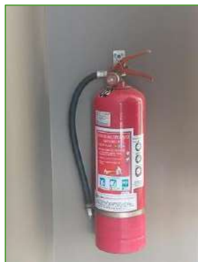
EXTINTOR DE PQS
