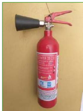
EXTINTOR DE CO2
