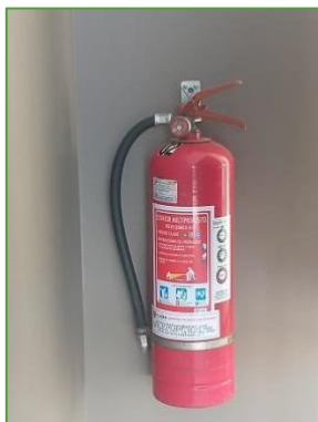
EXTINTOR DE PQS
