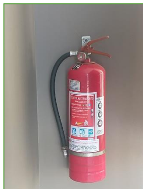
EXTINTOR DE PQS
