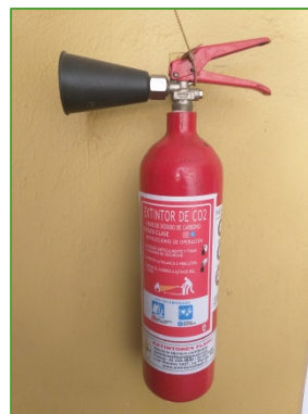
EXTINTOR DE CO2
