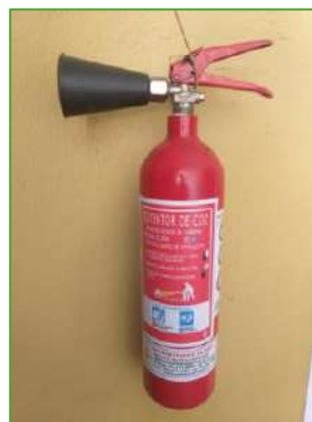
EXTINTOR DE CO2
