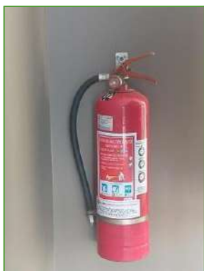
EXTINTOR DE PQS
